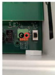
Collegamento pannello solare ed interruttore
