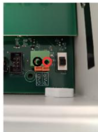
Collegamento pannello solare ed interruttore
